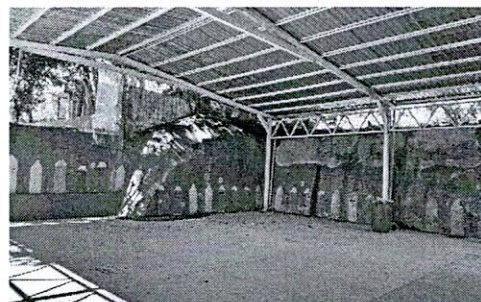
Foto 4: Se observa talud con grietas mínimas en el perímetro del talud afectado por las raíces del árbol
