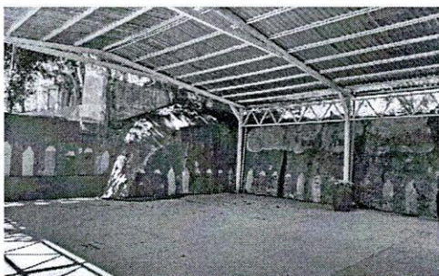
Foto 1: Se observa talud protegido con sabieta sin ningún tipo de refuerzo. Con afectaciones tipo grietas.
