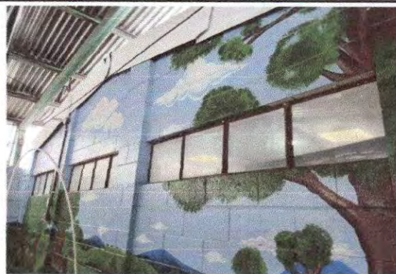
Ventanas en mal estado, plástico amarillento opaco y quebradizo, no se abren por lo que no hay ventilación, no permiten entrada de luz natural o aire fresco
