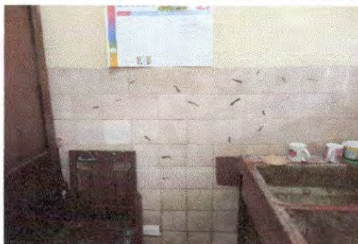
azulejos rotos, despegados manchados filtraciones de moho
