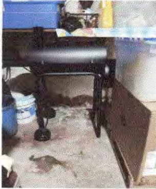
Filtración de agua y humedad en pared y piso
