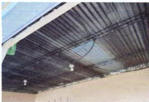
Estado actual de lámina y soportes costaneros, con filtraciones, corrosiones y desprendimiento
