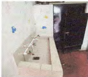
Estado actual de la pileta de los baños de los niños, los grifos no funcionan en su totalidad
