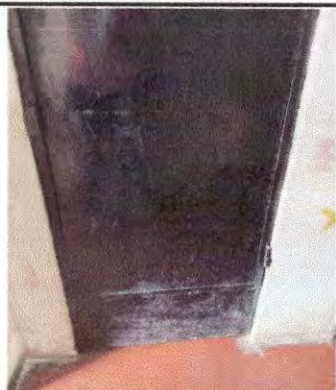
Estado actual de las puertas de metal de los baños de los niños, presentando corrosión, presencia de óxido, pintura levantada y perforaciones
