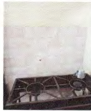
Estado actual de pared y azulejo del área de la cocina
