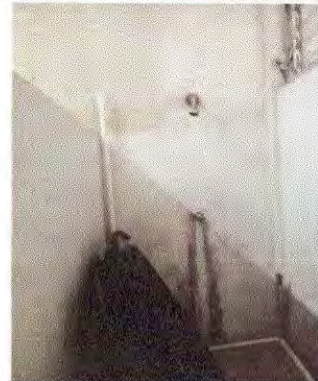
Regadera en mal estado, filtraciones en pared
