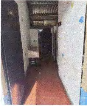
Estado actual de paredes de los baños de los niños sin azulejos
