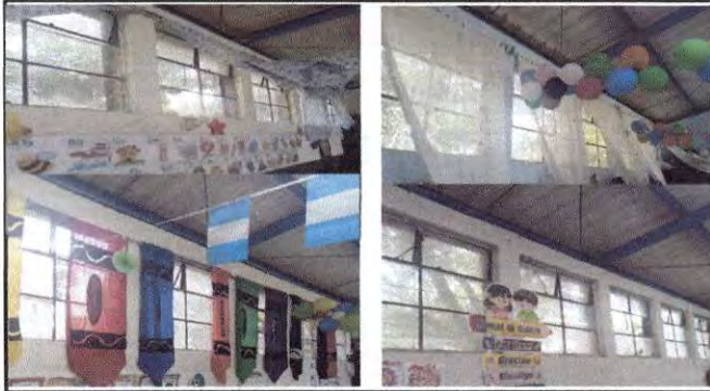
Foto1: Ventanas de metal en mal estado de 1.00x1.00 mts., actualizandolas a ventanas de PVC de mejor calidad.
