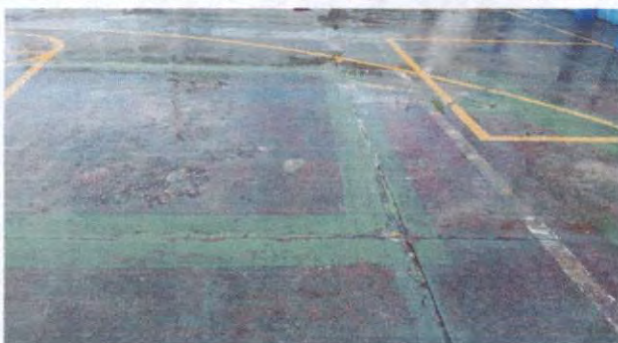
Foto 3: el agua se filtra a través de la losa provocando el desprendimiento inferior, provocando grietas estructurales y fisuras transversales.
