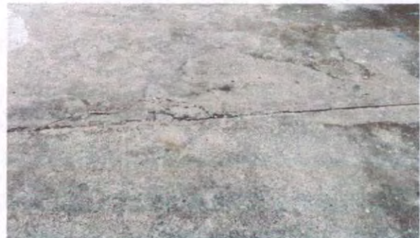
Foto 2: estos daños de la losa comprometen la seguridad estructural como el uso diario del espacio de juego para los estudiantes.
