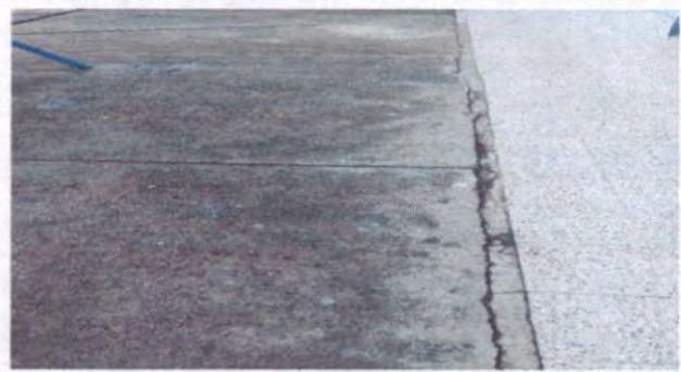
Foto 4: las grietas y desniveles que se observan pueden provocar accidentes, ya que los alumnos pueden tropezar o caer y lastimarse físicamente.
