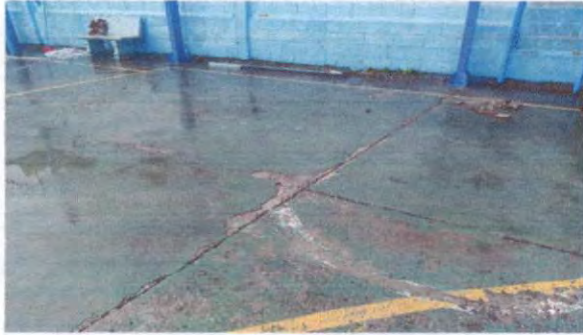
Foto 1: reparación de losa del patio por desprendimiento de la capa superficial.
