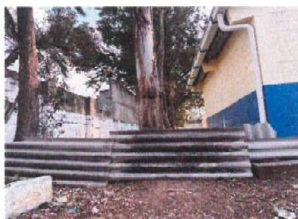
Foto 7: 11.2 Sustrucción de cerramientos informales por barranda metálica 2 conpuertas abatibles y 2 fijos sin puerta.
