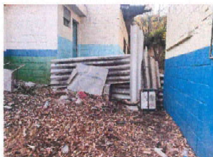
Foto 8: 11.2 Sustrucción de cerramientos informales por barranda metálica 2 conpuertas abatibles y 2 fijos sin puerta.
