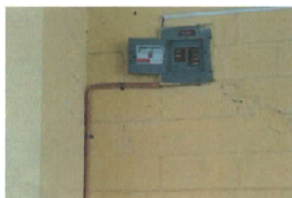
Foto 11: SUSTITUCIÓN DE FLIPONES (CAJA DE FLIPONES 1 NIVEL) TOTAL 1 DE 40 AMPERIOS
