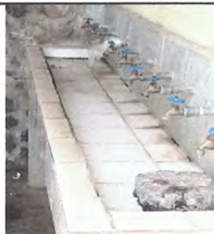
Foto 6: 14.13 Mantenimiento de 4 llaves de chorro en mal estado (sustitución por 4 marca grival, y sellar 3 en mal estado, en sanitario de niñas
