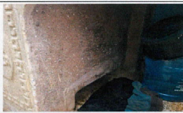
Foto 16: Cambio de pila por filtración
