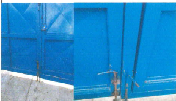
Foto 3: Mantenimiento del portón dañado el día del incendio, ajustar y emparejar
