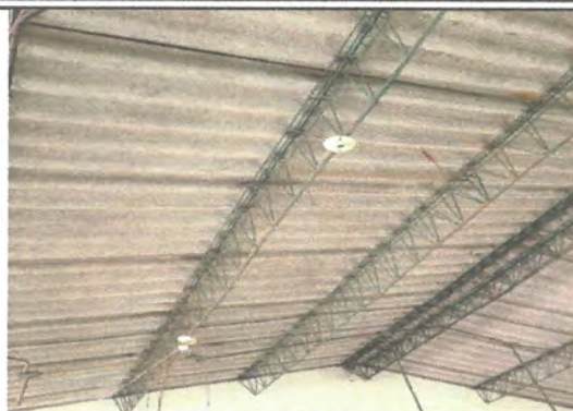
FOTO 2: Remosado de estructura tipo yois
