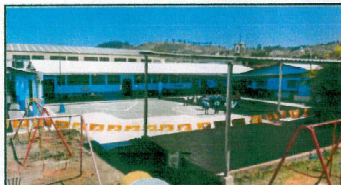
FOTO 11: Pintura en piso de patio principal
