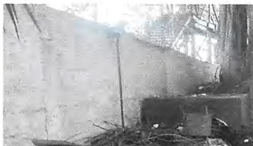
Foto 3: Levantado de muro perimetral dañado y quebrado del lado interno de la Escuela
