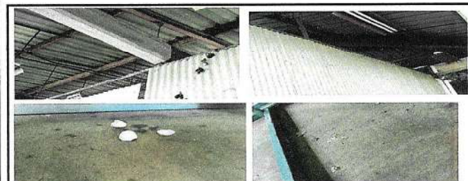
Foto 5: Se necesita el cierre perimetral de los talleres formativos de 6to. Perito secciones "A" y "B" y el de 5to. Perito sección "B" debido a que ingresan a las intalaciones el polvo y aves las cuales son focos de contaminación al momento de elaborar alimentos y bebidas.
