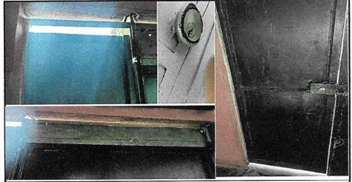
Foto 2: Es necesario remplazo puertas de los talleres formativos de cocina de los grados 4to. "B" y 5to. Perito sección "A", debido a que han sufrido de deterioro por el uso y las condiciones ambientales (lluvia, luz solar, cambios de temperatura) han causado su desgastes y por ser parte de las medidas de seguridad para resguardar a los estudiantes y al equipo con el que cuentan las instalaciones es imprescindible su remplazo. Al igual que un refuerzo en el cocreto/fundición en donde se encuentran.
