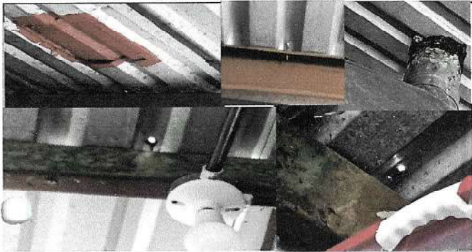
Foto1: Se solicita reparación en áreas de los talleres formativos de cocina de los grados 4to. "B" y 5to. Perito sección "A", pues requieren de remplazo de laminas del techo debido a que por la antigüedad la presentan de óxido y perforaciones, por ende se requiere cambiarlas por seguridad de los educandos y para resguardar el equipo y las instalaciones.
