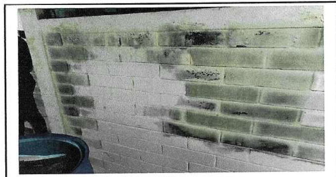
Foto 10: Se necesita que se realice la revisión y reparación de una filtración de agua corriente la cual está generando humedad y daños a la infraestructura del establecimiento.
