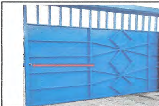
Foto 8: SUSTITUCIÓN DE CHAPA DE ENGRAPE YALE PARA PORTON PRINCIPAL, YA QUE ESTA BAJO EL ENGRAPE Y DESGASTADA.
