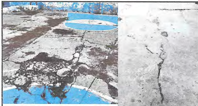
Foto 7: LOSA DE PATIO, PAÑUELOS MUY GRETADA Y DAÑADA DICHA AREA.
