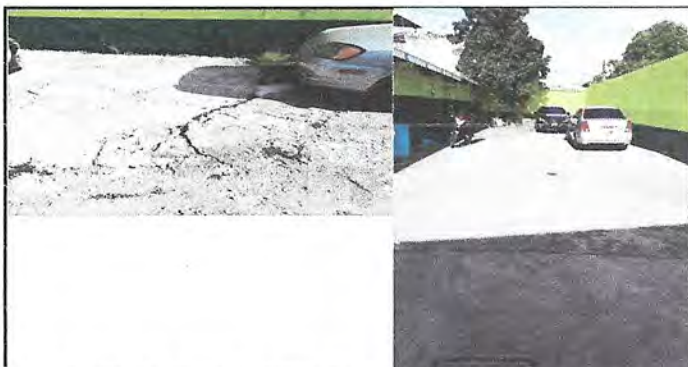
Foto 4: LOSA DEL AREA DE PARQUEO YA QUE ESTA GRETADA Y DESNIVELADA.
