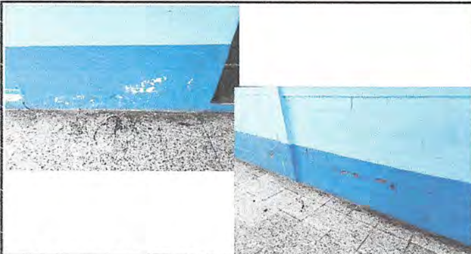
Foto 1: PINTURA EN MUROS EXTERNOS DE AULAS, CORREDORES. YA ESTA MUY DESGASTADO.
