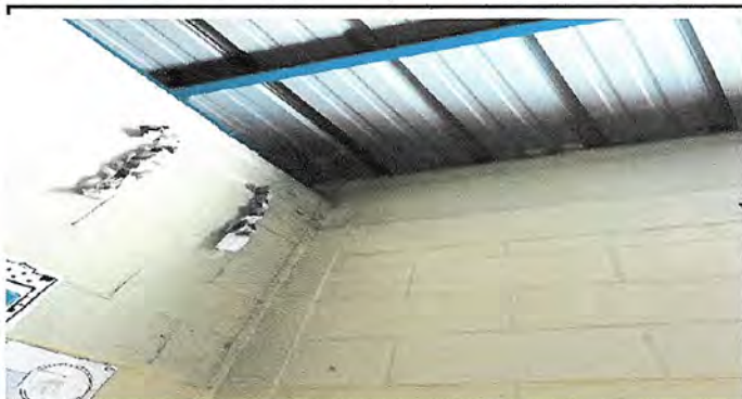
Foto 2: Gotera aula segundo nivel
