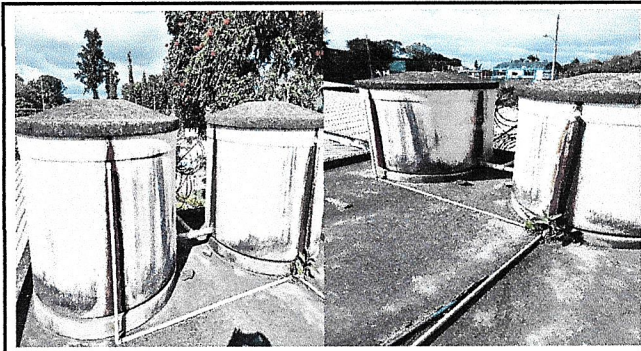
Foto 4: COLOCACION DE TINACOS NUEVOS YA QUE LOS QUE SE TIENE ESTAN ABSOLETOS Y OXIDADOS.
