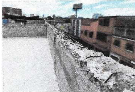
Foto 2: Reparación de corniza de la pares de 15 metros lineales pared frontal de la escuela en la parte de la terraza los hierros están expuestos
