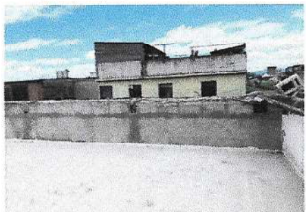
Foto 3:Reparación de corniza de la pares de 15 metros lineales pared frontal de la escuela en la parte de la terraza los hierros están expuestos
