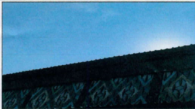
En laminado por ingreso de palomas en contorno de la escuela en techo de 2do nivel con lamina aluzin lisa y tornillos de sujecion
