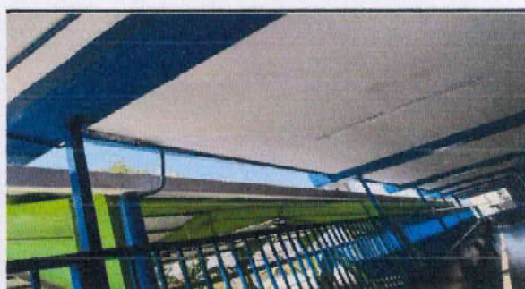
En laminado por ingreso de lluvia en 2do nivel de escuela con lamina aluzin lisa calibre 26 y tornillos de sujeción
