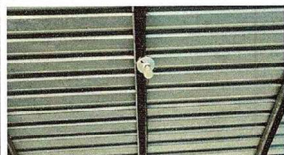
Foto 9: 17.3 Sustitución de lamparas tipo LED
