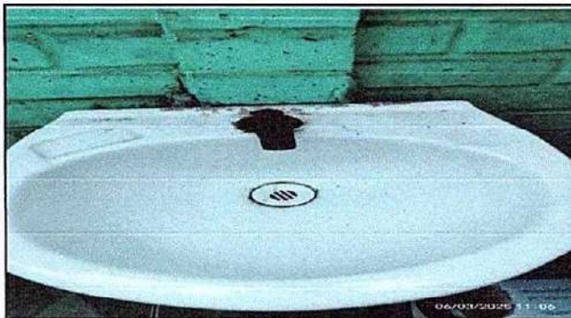
Foto 10: Sustrucción de mezcladora lavamanos (contra llave, tubo e abasto), Sustrucción de grifos, área de sanitarios.
