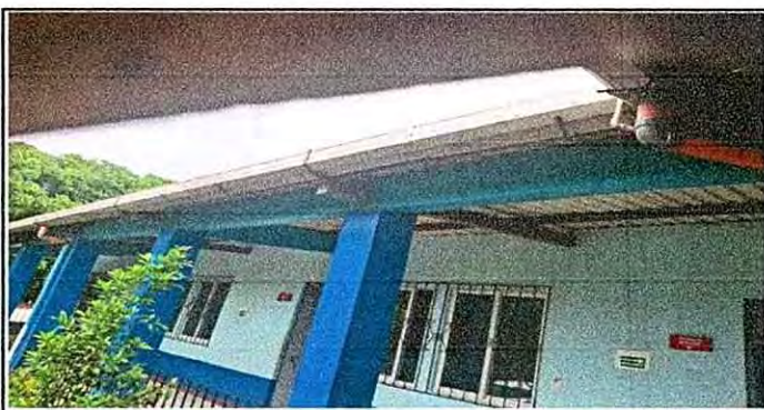
Foto 5: Sustrucción de soporte o pescante de metal para canal
