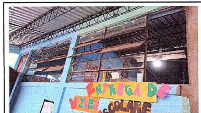
Foto 9: Sustrucción de estructura de metal de ventana
