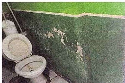
Foto 16: Sustrucción de azulejo.
