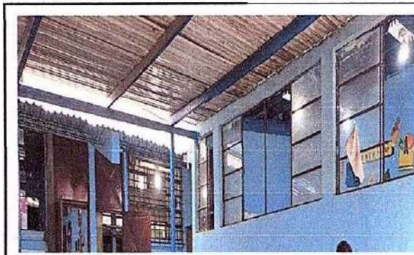
Foto 10: Sustrucción de estructura de metal de ventana
