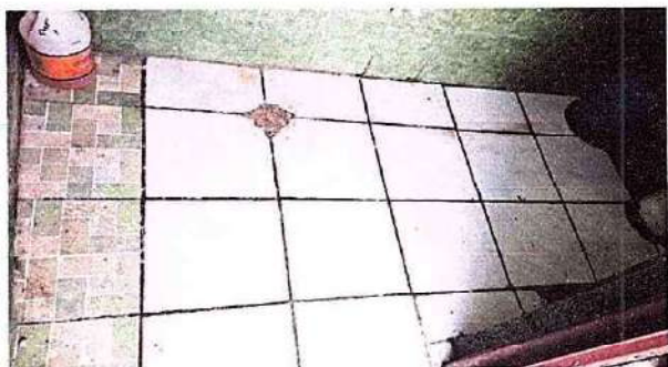
Foto 13: Sustrucción de piso cerámico en baño.
