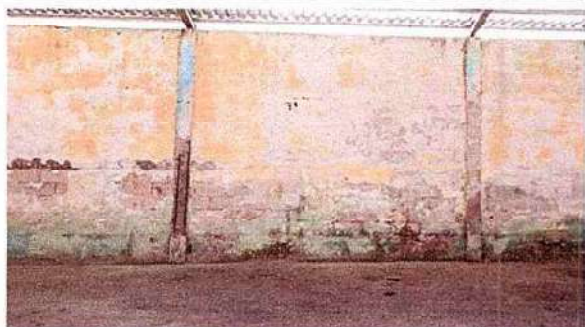
Foto 8: Region 21.1 (Repello en muro)
