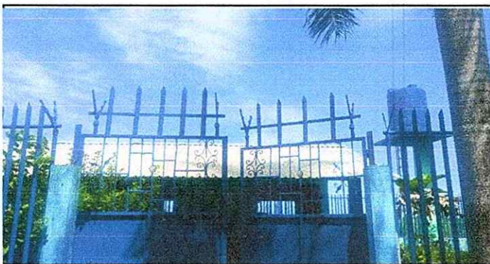
Foto 5: Renglón 4.5, 19.7 El portón necesita cambio, no cierra con la chapa y necesita cambios de visagras.
