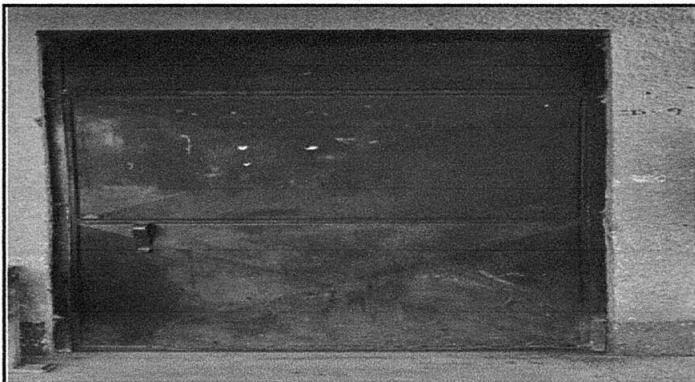
Foto 1: Las seis puertas necesitan el mantenimiento en su estructura, tal y como lo establece el renglon mismo, de puertas de metal 4.1 en la parte baja cambio total de lo deteriorado.
