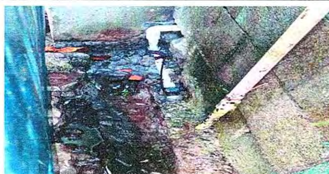
Foto 4: 14 Red de Drenaje
