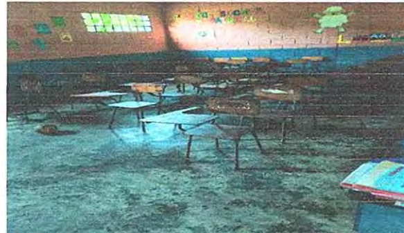
Foto 4: El piso de los salones está dañado y manchado. Es necesario el cambio para que los estudiantes estén en un mejor ambiente al recibir las clases.
