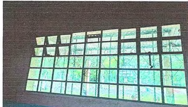
Foto 2: El daño de las ventanas es evidente y se necesitan cambiarlas porque no entra ventilación, los vidrios están pegados.
