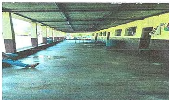
Foto 3: El corredor de la escuela ya está severamente dañado, ya tiene hoyos por el tiempo que tiene.
