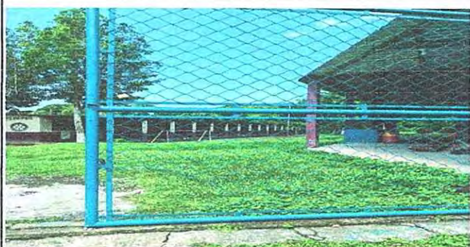
Foto 1: Se puede observar el daño que tiene el portón, el daño que tiene provoca que los niños se salgan por los grandes agujeros que tiene.
