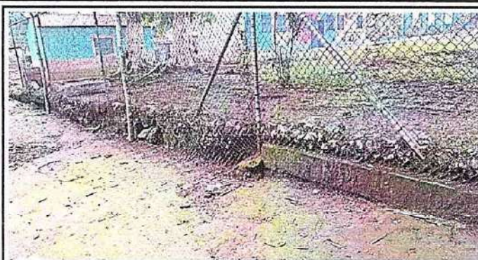
Foto 2: La malla y los tubos se encuentran en mal estado, la cual se rompe con facilidad
