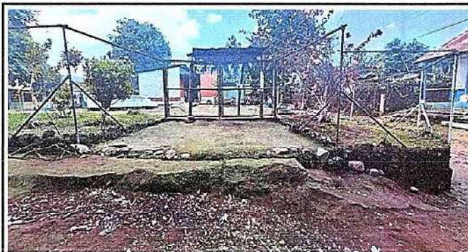
Foto 3: El perímetro se está socabando, lo cual hace que la malla no proporcione seguridad
