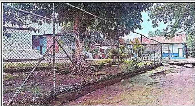
Foto 1: El perímetro el cual tiene como base fundición de cemento se encuentra en deterioro.
