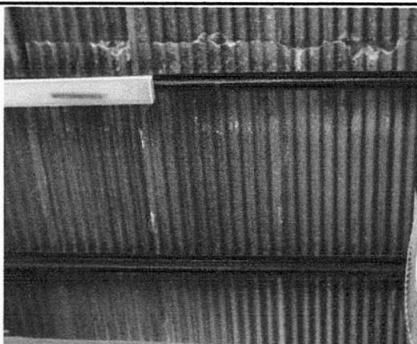
Foto 3: 2. ESTRUCTURA DE TECHO 2.1 Mantenimiento de estructura de soporte de metal
