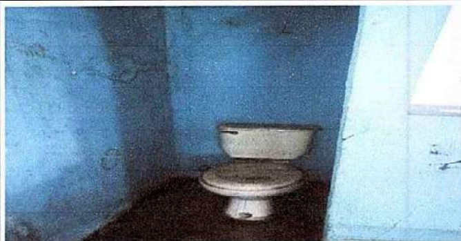
Foto 15: Servicio sanitario en malas condiciones.
