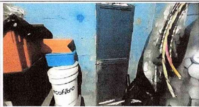
Foto 4: Puertas en mal estado.
