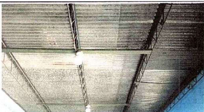
Foto 3: Costaneras y estructura de soporte en condiciones deterioradas.
