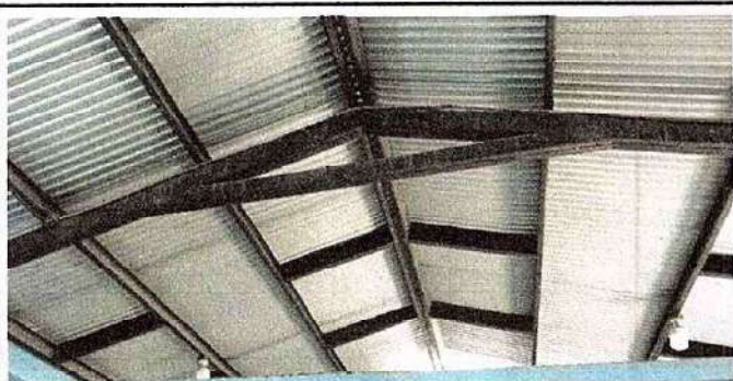
Foto 9: Estructura de soporte de metal en mal estado.
