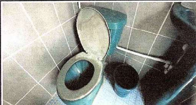
Foto 8: Servicio sanitario en mal estado.
