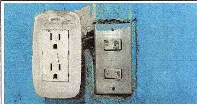
Foto 10: Tomacorrientes en estado deteriorado.
