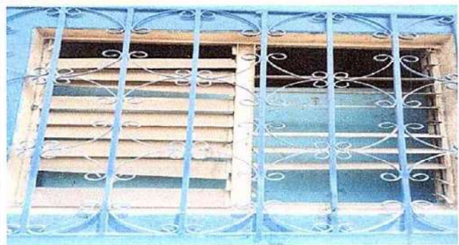
Foto 13: Ventana en mal estado .
