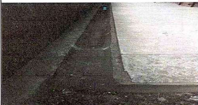
Foto 7: 8.1 Reparación de cuneta de concreto. Se colocara rejilla, soldada para que los estudiantes tengan seguridad, pues el ciclo anterior una estudiante de sexto primaria se quebró el tobillo en la misma
