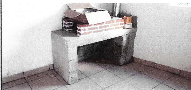
Foto 11: Instalacion de cocina rural
