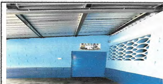
Foto 3: PUERTAS DE METAL
