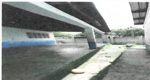
Foto 4: MODULO CANALES Y BAJADA DE AGUA PLUVIAL
