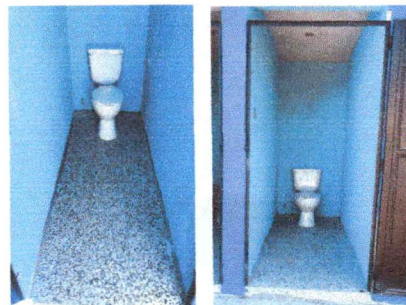
Foto 4: SANITARIOS (SUSTITUCIÓN DE DOS INODOROS EN MAL ESTADO Y UN LAVAMANOS)
