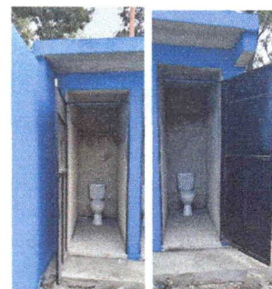
Foto 4: SANITARIOS (SUSTITUCIÓN DE DOS INODOROS EN MAL ESTADO Y UN LAVAMANOS)
