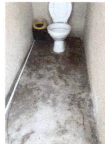
Foto 4: SANITARIOS (SUSTITUCIÓN DE DOS INODOROS EN MAL ESTADO Y UN LAVAMANOS)
