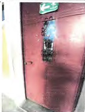
Foto 1: PINTURA Y SUSTITUCIÓN DE CHAPAS DE LAS PUERTAS, DEBIDO QUE LA PINTURA ESTÁ DETERIORADA Y LAS CHAPAS NO FUNCIONAN PORQUE YA NO ESTAN EN BUEN ESTADO, SUSTITUCIÓN DE UNA
