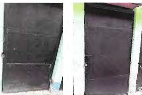
Foto1: Puertas de baños en mal estado, necesitan pintado y arreglo de pasadores.
