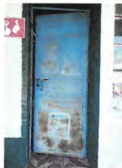
Foto 2: Puerta de cocina en mal estado.
