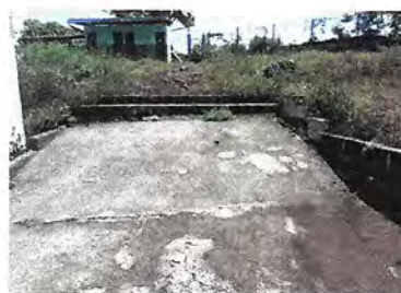
Foto 4: Losa de patio bastante dañada.
