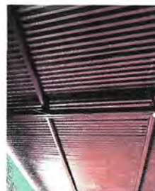
Foto 6: Sistema eléctrico en mal estado.
