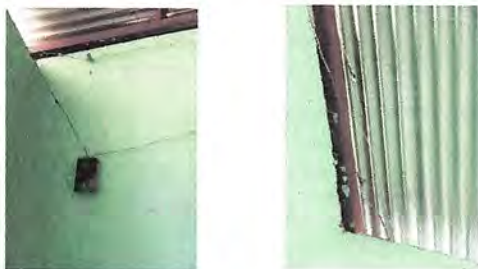
Foto 5: Sistema eléctrico en mal estado.
