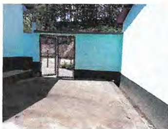
Foto 3: Portón muy pequeño lo que restringe el acceso de vehículos.
