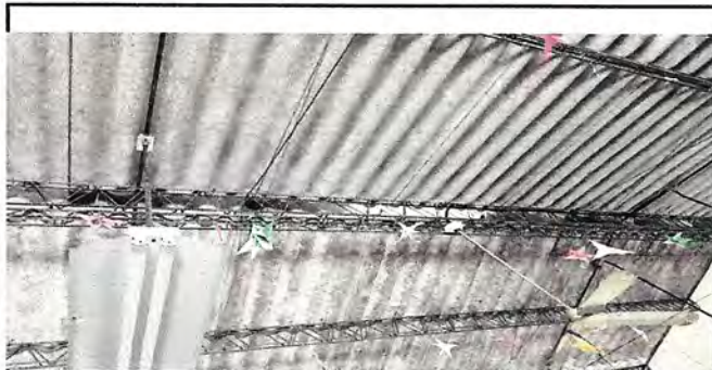
Foto 3: Se puede observar el deterioro y las separaciones del techo y las grietas con que se encuentran,
