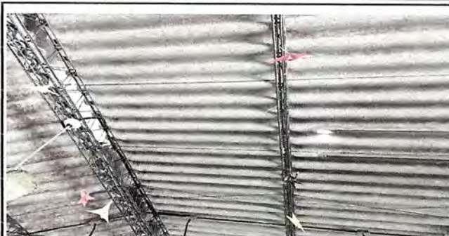
Foto 2: Se observa los orificios del techo por donde se introduce las aguas de la lluvia.
