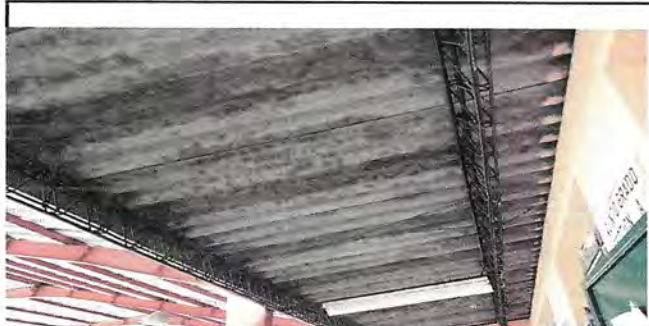
Foto1: techo actual y en deterioro
