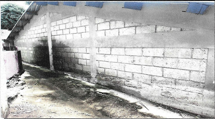
Foto 1: Muro perimetral colindante con el cementerio a través de la cual se filtra el agua.
