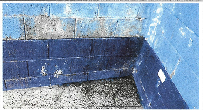
Foto 3: Paredes en mal estado por filtración de agua
