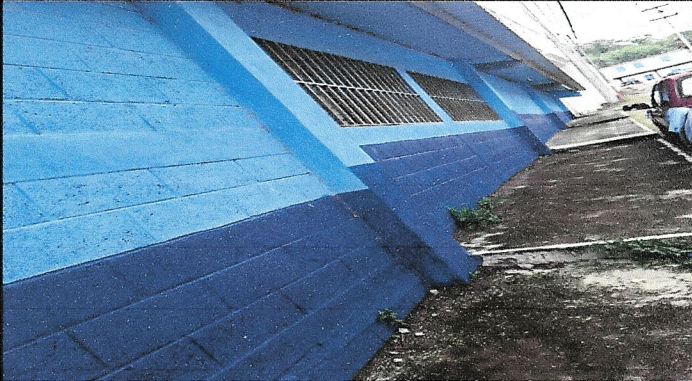
Foto 2: Muro Perimetral colindante con calle, a través de la cual se filtra el agua
