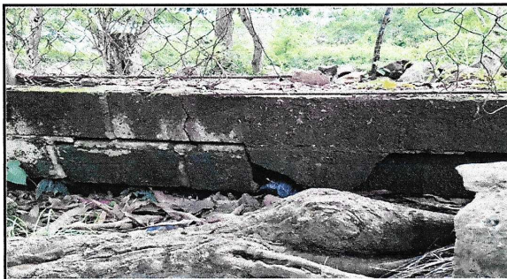
Foto 3: Primera parte del muro dañado
