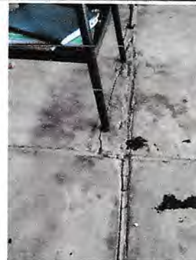
Foto 2: PISO EN AULA NO. 4 DAÑADO DESNIVELADO NECESITA RETIRADO Y SUSTITUIDO
