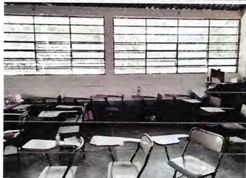
Foto1: AULA NO. 4 CON PISO DE CONCRETO DAÑADO DESNIVELADO NECESITA RETIRADO Y SUSTITUIDO}
