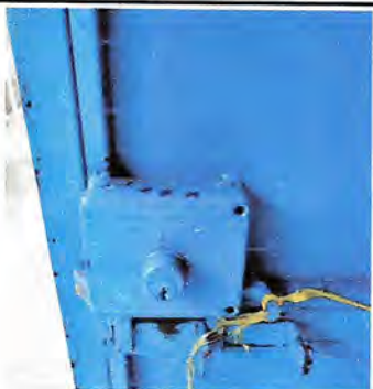
Foto 5: PUERTA DE AULA NO. 4 NECESITA CAMBIO DE CHAPA Y MATENIMIENTO A ESTRUCTURA METALICA
