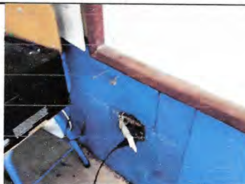
Foto 4: TOMACORRIENTES EN AULA NO. 4 NECESITA SUSTITUCION, CAMBIO DE CABLEADO
