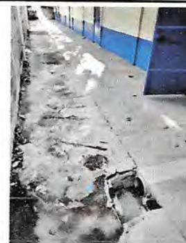
Foto 6: CAJA PLUVIAL NECESITA REPARACION Y REJILLA
