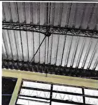
Foto 3: ILUMINACION EN AULA NO. 4, NECESITA LUMINARIA TIPO LISTON
