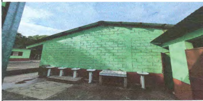
Foto 2: Estructura de techo; Sustrucción de estructura de soporte de metal en el área de sanitarios y lavamanos.
