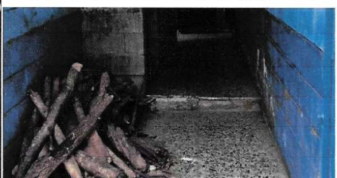
Foto 5: PISO DE COCINA
