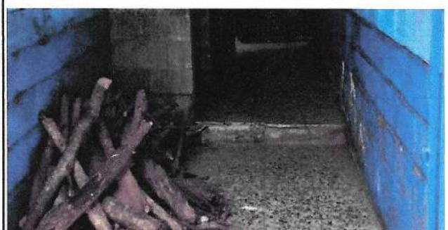
Foto 5: PISO DE COCINA
