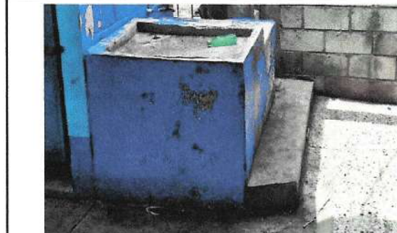
Foto 6: PILA DE COCINA
