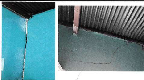
Foto 3: Estado actual de paredes
