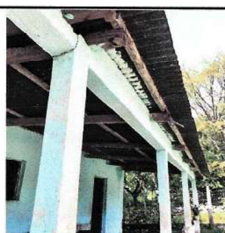
Foto 6: Estado actual de pintura en el establecimiento
