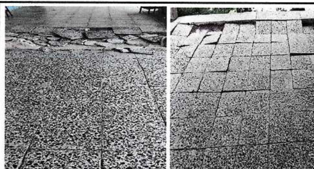
Foto 4: Estado actual de piso de la escuela
