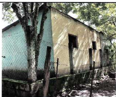
Foto 5: Paredes muy bajas
