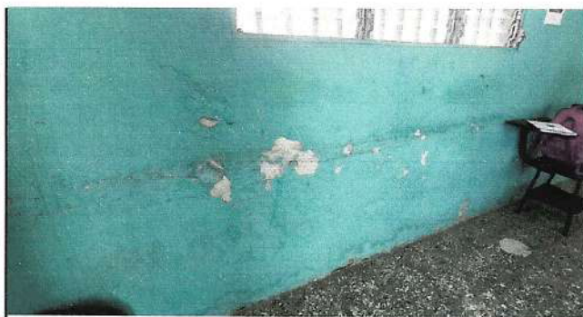
Foto 5: Mal estado de la pintura en las paredes.
