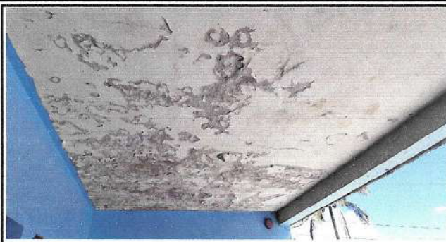
Foto 1: Mal estado del cernido de la loza por la filtración de agua
