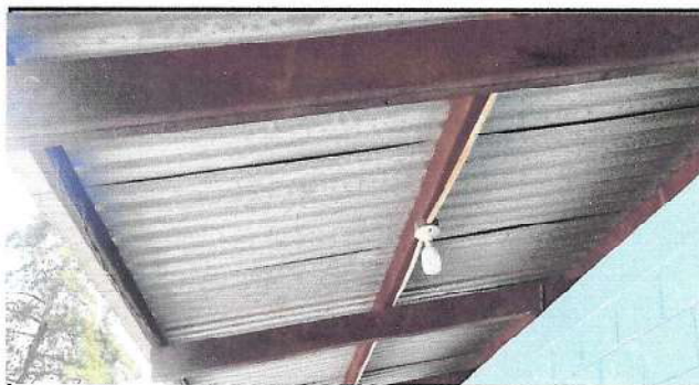
Foto 4: Estructura de metal con inicios de oxidación.
