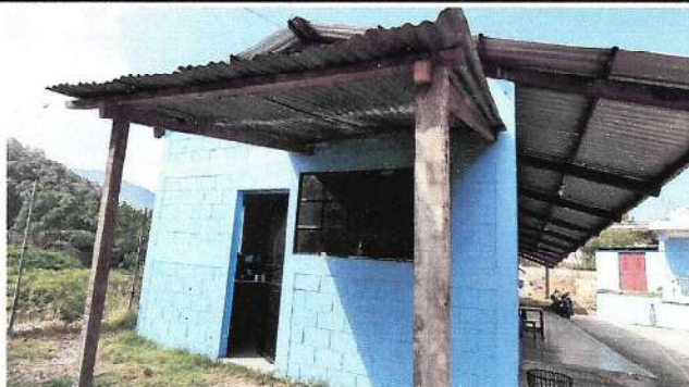
Foto 2: Estructura de techo con lámina en mal estado y soporte de madera.
