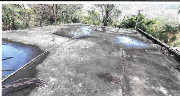
Foto 3: Losa en mal estado, donde hay mucha filtración de agua.
