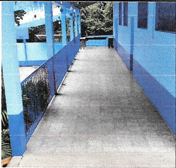
Foto 2: PISO EN CORREDOR
