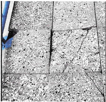
Foto1: PISO EN CORREDOR
