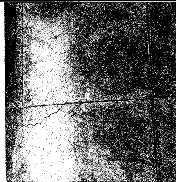
Foto 2: PISO EN AULAS
